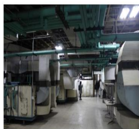
Sala de máquinas de calefacción, que capturan aire frío, lo calientan, e inyectan a los pisos 3 y 4.
